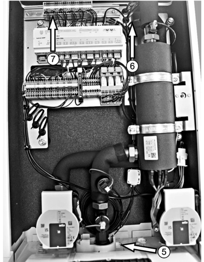
Abb. 42: Kabelführung zur X20 Klemmleiste Kleinspannung
