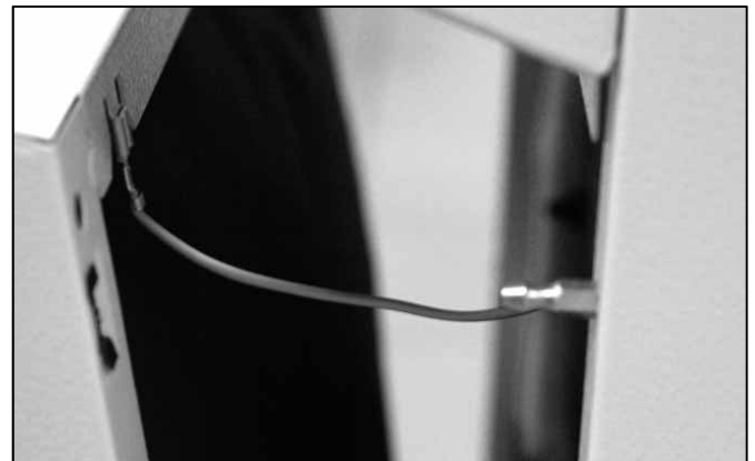
Abb. 26: Schutzleiter zwischen Frontverkleidung und Verkleidungsdeckel
