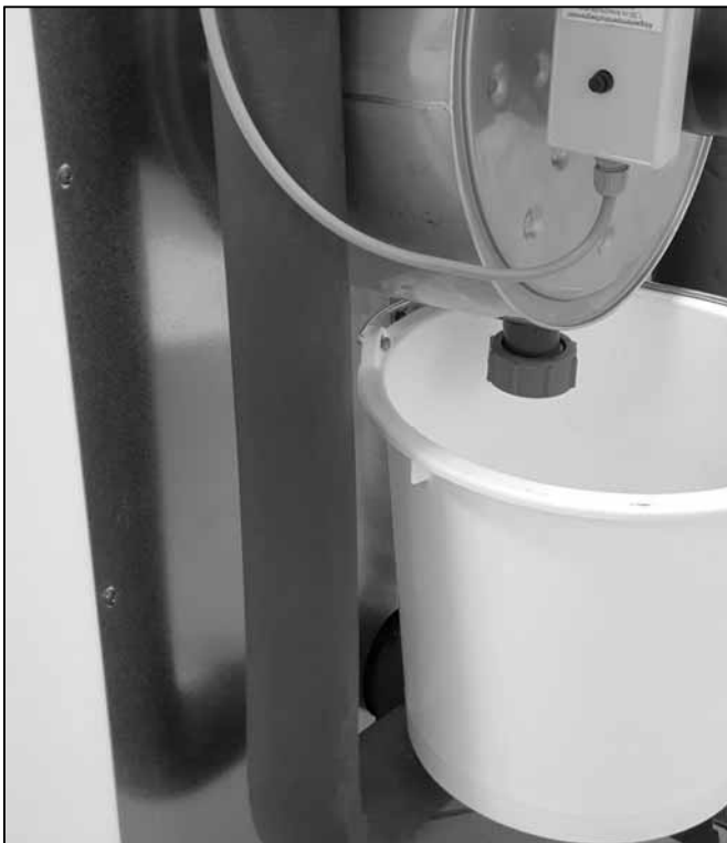
Abb. 85: Eimer unter dem Siphon-Anschluss des Abgaswärmetauschers
