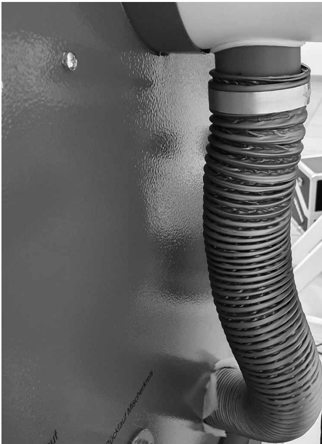
Abb. 12: Zuluftschlauch am Kesselabgasanschluss
