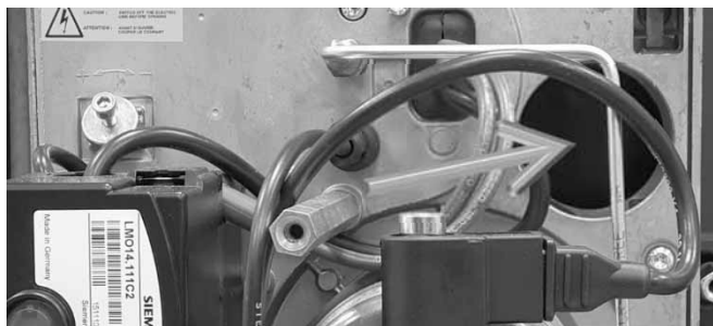
Abb. 9: Luft-Ansaugöffnung des Blau-Brenners BNR
