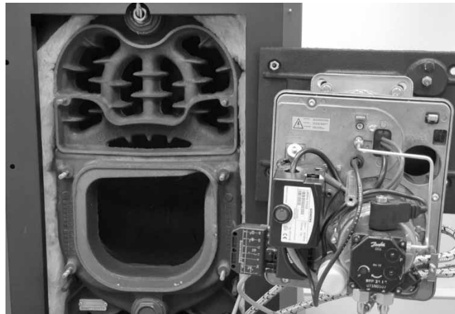
Abb. 86: Geöffneter Kessel mit Brenner in Serviceposition.
