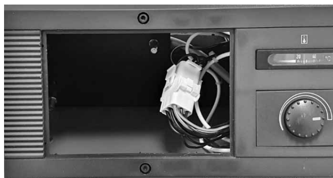
Abb. 30: Offener Reglerschacht mit Steckverbindung für den Regler-Kabelbaum.
