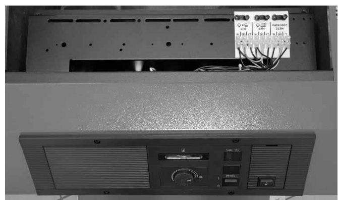
Abb. 28: Kessel-Grundschaftfeld ohne Regelung und Montagebereich für Anschluss-Klemmbrett
