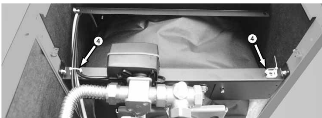
Abb. 26: Kabelführungen an der Querstrebe ④
