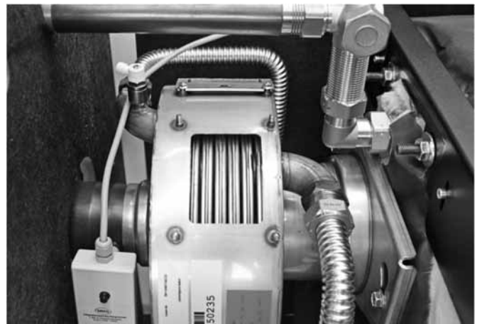
Abb. 89: Reinigungsöffnung des RWT
