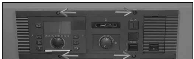
Abb. 35: Befestigungsschrauben des Kesselschaltfeldes
