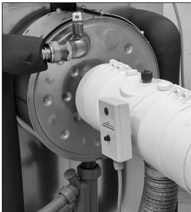
Abb. 15: Montierter Kessel-Anschluss DN80/125 mit Zuluftschlauch.
