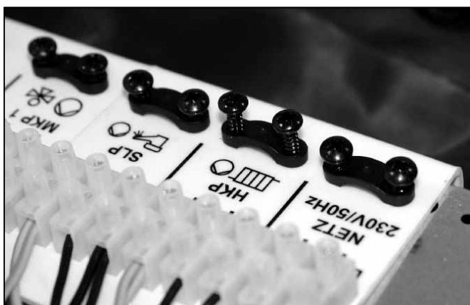
Abb. 25: Lüsterklemmen und Zugentlastungen
