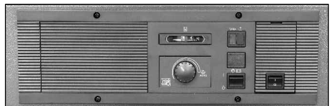
Abb. 27: Kesselschaltfeld mit Grundfunktionen
