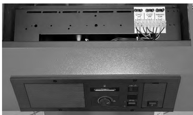
Abb. 28: Kessel-Grundschaufeld ohne Regelung und Montagebereich für Anschluss-Klemmbrett
