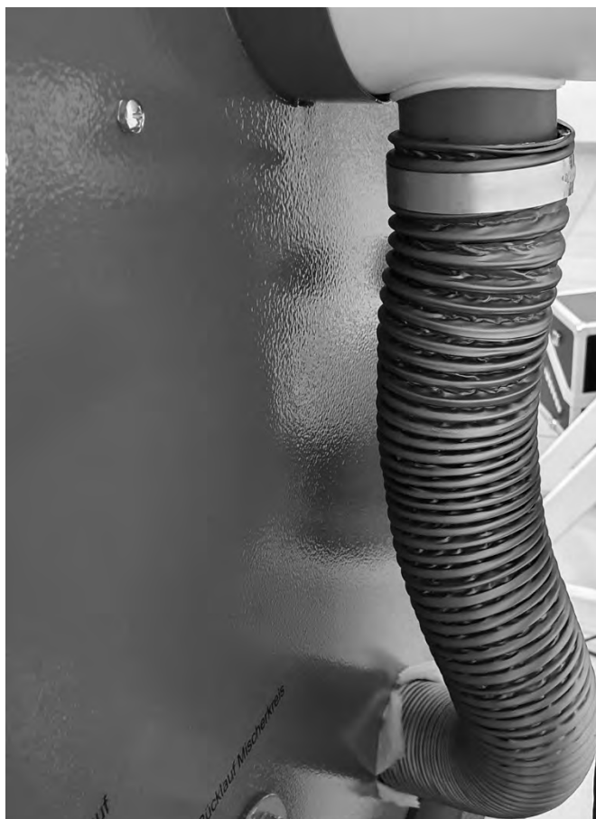
Abb. 12: Zuluftschlauch am Kesselabgasanschluss
