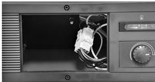
Abb. 30: Offener Reglerschacht mit Steckverbindung für den Regler-Kabelbaum.
