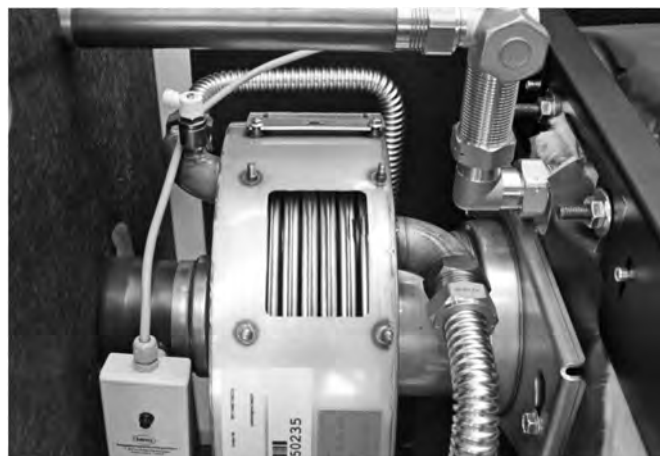
Abb. 89: Reinigungsöffnung des RWT
