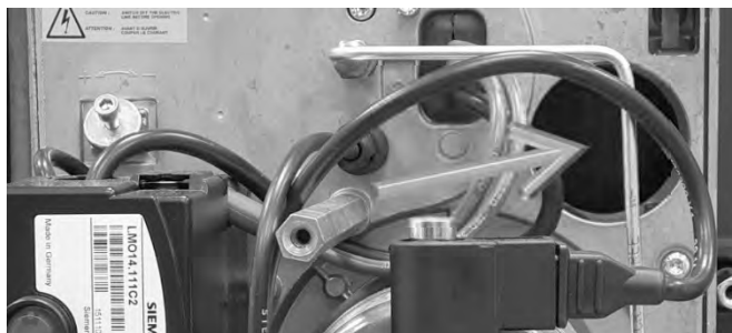
Abb. 9: Luft-Ansaugöffnung des Blau-Brenners BNR
