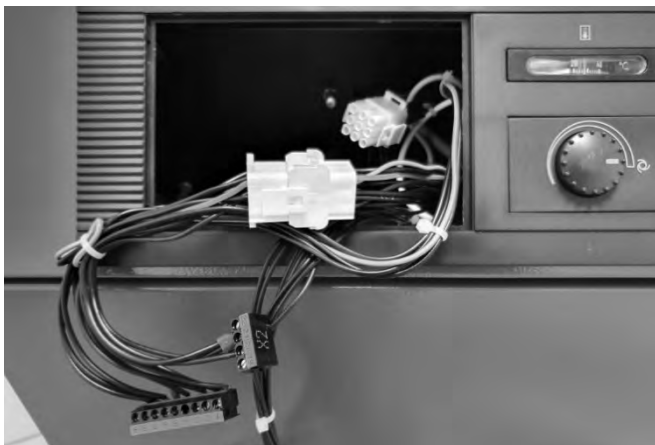
Abb. 105: Getrennte Anschlussstecker für den Regler.
