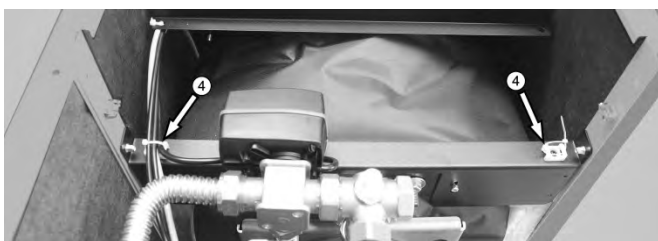
Abb. 26: Kabelführungen an der Querstrebe ④
