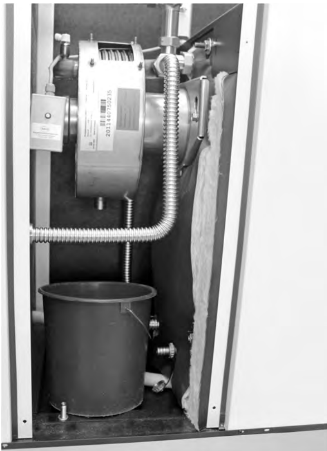
Abb. 90: Zur Reinigung vorbereiteter RWT
