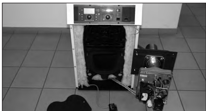
Abb. 83: Geöffneter Kessel mit Brennentür in Wartungsposition
