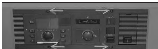
Abb. 35: Befestigungsschrauben des Kesselschaltfeldes
