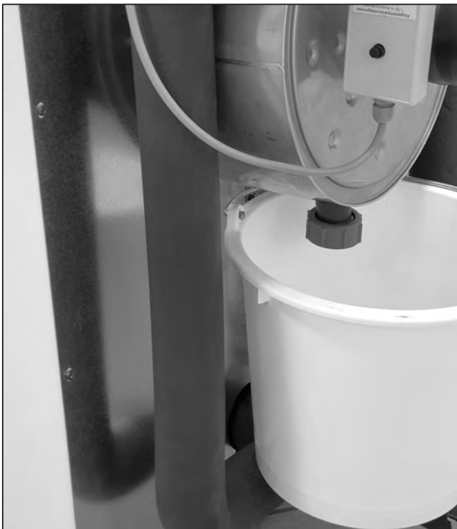
Abb. 85: Eimer unter dem Siphon-Anschluss des Abgaswärmetauschers
