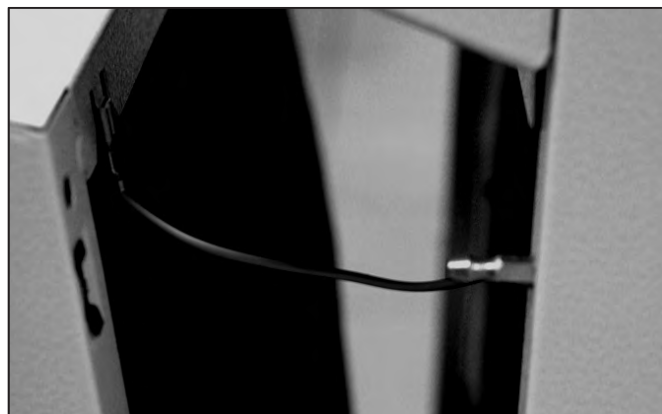
Abb. 26: Schutzleiter zwischen Frontverkleidung und Verkleidungsdeckel
