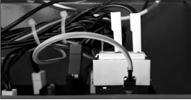
Abb. 36: Aufsicht Kessel-Sicherheitstemperaturbegrenzer (STB) (rechts oben im Kesselschaltfeld)
