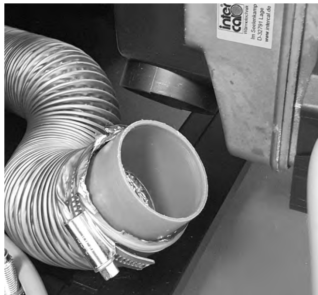
Abb. 13: Zuluftschlauch mit 50 mm Anschluss-Stück
