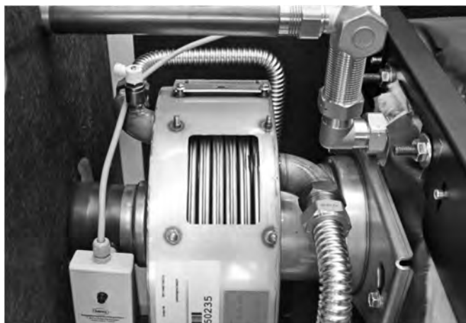
Abb. 88: Reinigungsöffnung des RWT
