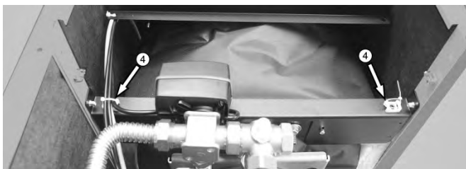
Abb. 25: Kabelführungen an der Querstrebe ④
