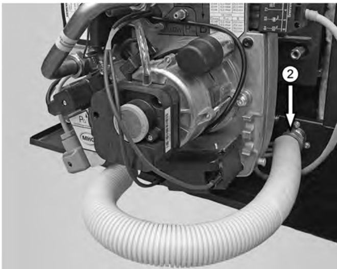
Abb. 19: Brenner-Gasanschluss ② am Kessel
