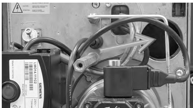
Abb. 9: Luft-Ansaugöffnung des Blau-Brenners BNR
