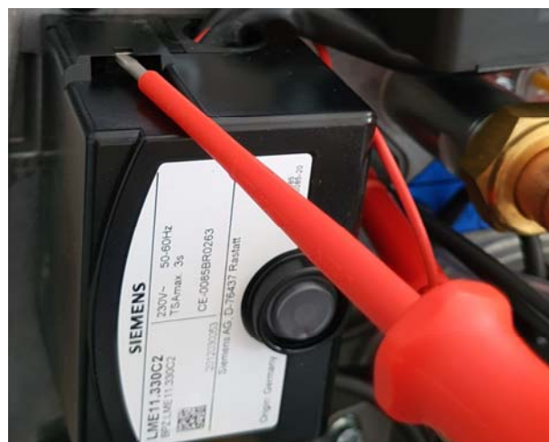
Abb. 3: Schlitzschraubendreher an der Edelstahlfeder oben am Gehäuse des Feuerungsautomaten.
