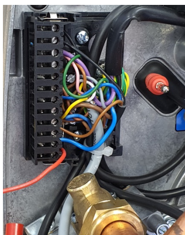
Abb. 5: Stecksockel ohne Kabelhalter und gelöste Steckverbindung.
