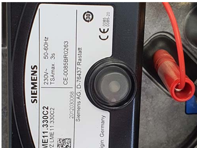
Abb. 22: Steckverbindung der Ionisationsleitung.
