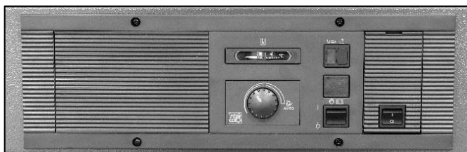
Abb. 29: Kesselschaltfeld mit Grundfunktionen
