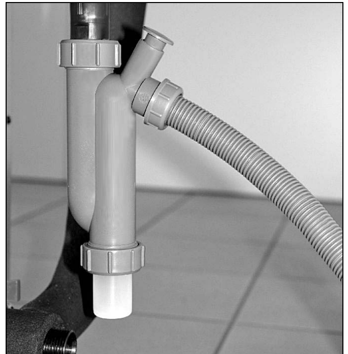
Abb. 82: Siphon und Kondensatschlauch
