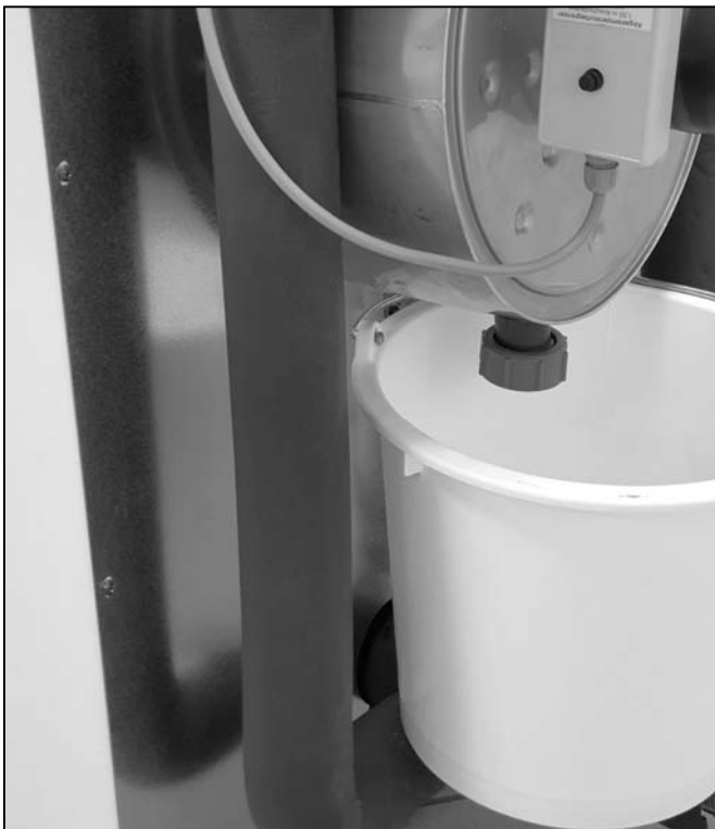
Abb. 87: Eimer unter dem Siphon-Anschluss des Abgaswärmetauschers
