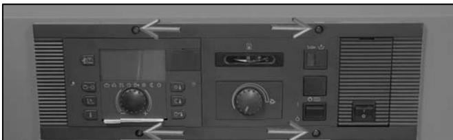
Abb. 37: Befestigungsschrauben des Kesselschaltfeldes
